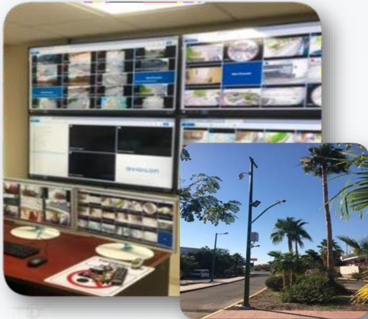
CCTV Y MONITOREO
